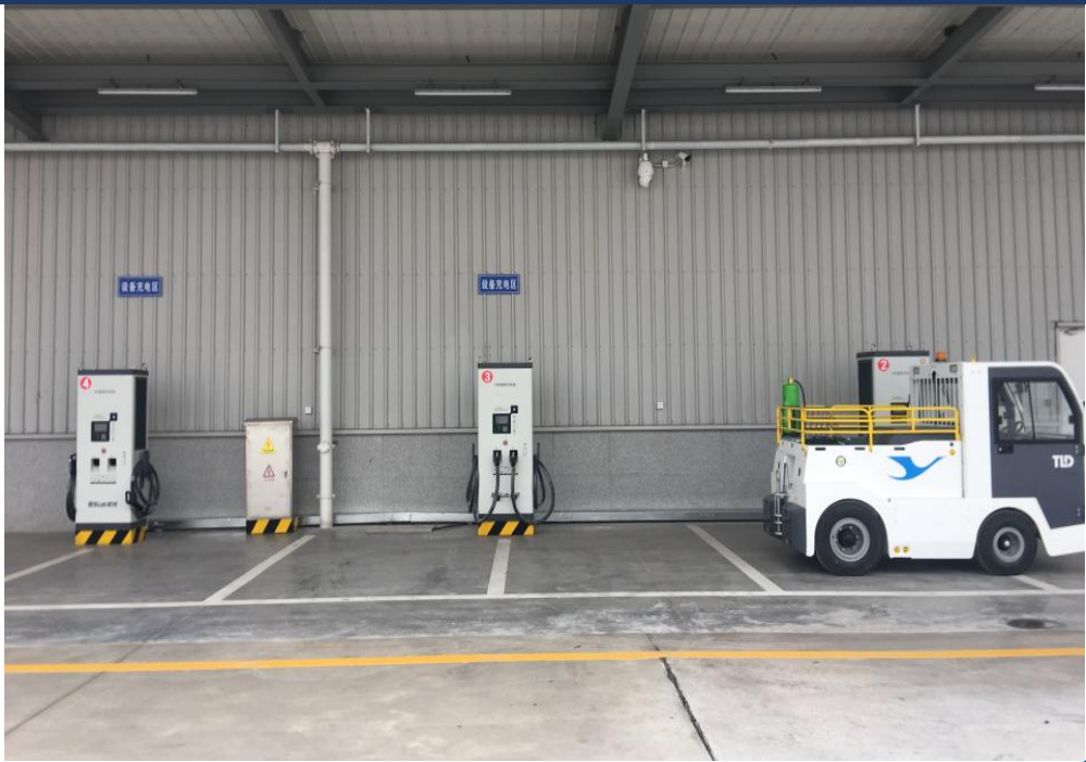
杭州萧山机场充电站 ✓
