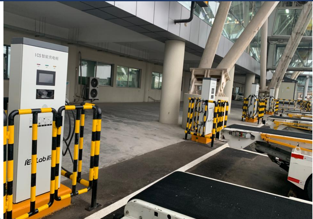
济南遥墙机场充电站 ✓
